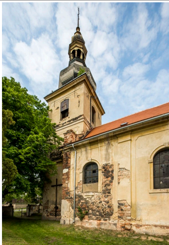
Západní část jižního průčelí lodi a věže v pohledu od jihovýchodu. Foto: Marta Pavlíková 2019.
